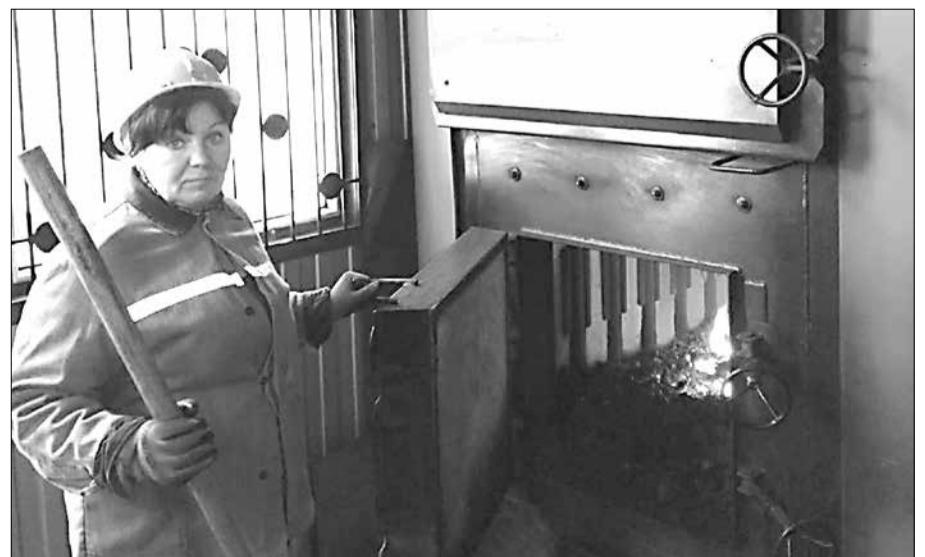
Машинист котла А.И. Маслова доставляет топливо в котел ВРС1000.
